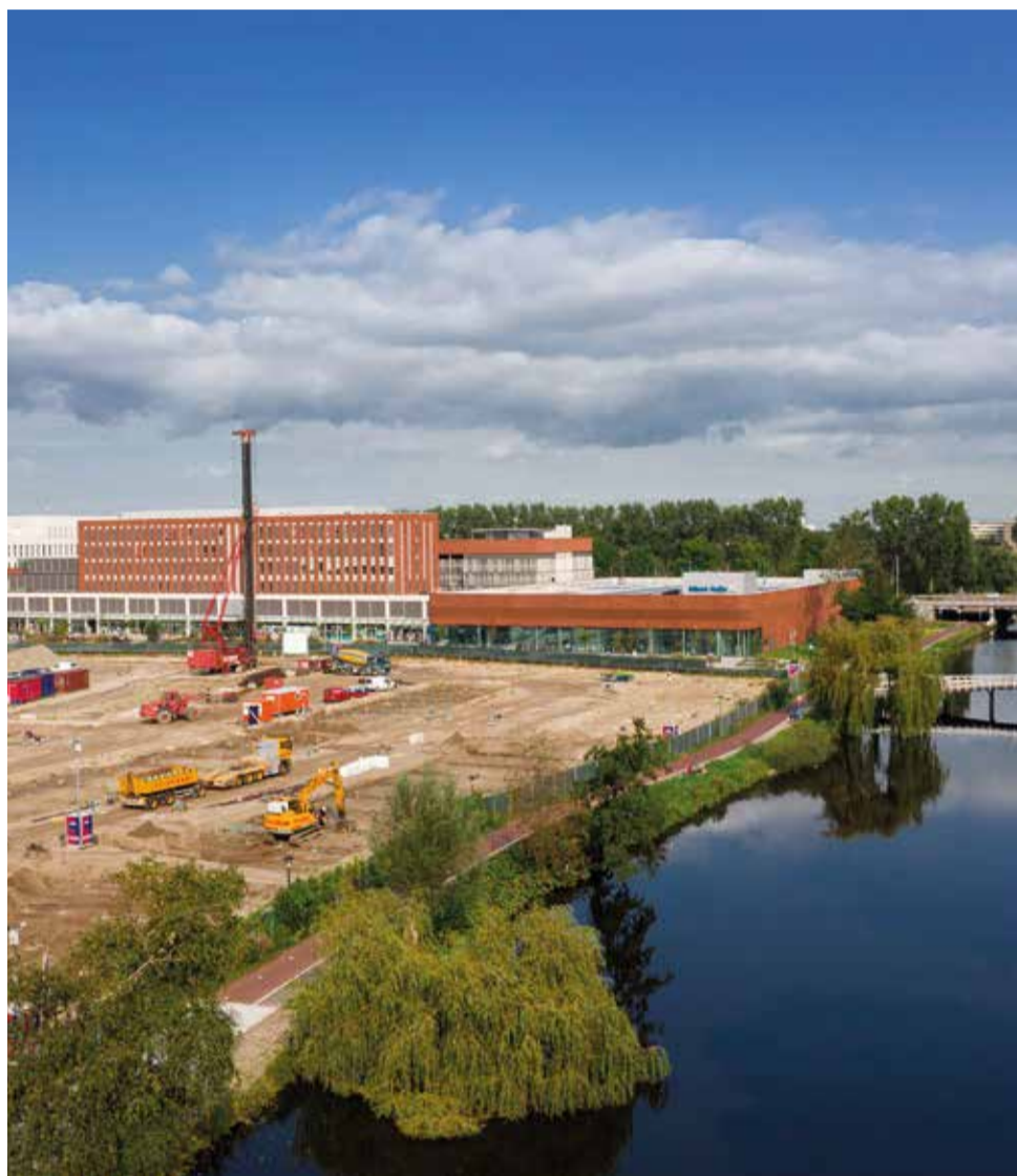
De nieuwbouwwoningen in het Gouwpark krijgen straks warmte via het warmtenet. Fotograaf: Jack Tillmanns
